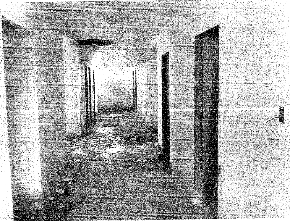
Foto nº 13: Forro de gesso danificado na circulação, provocado por infiltrações.
